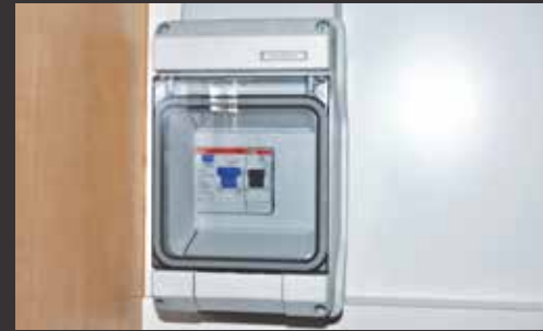
Verteilerkasten mit FI und Sicherung (16 Ampere)
